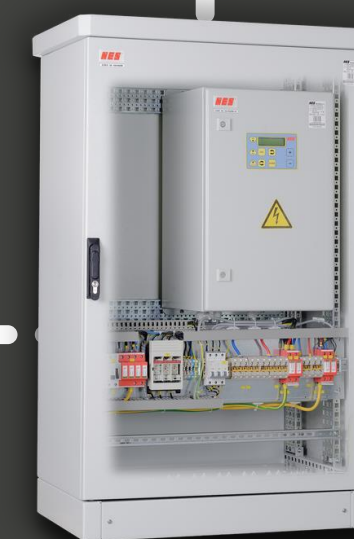
Stanice pre katódovú ochranu
